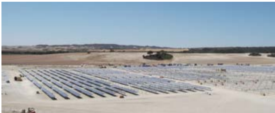
Zuera 11 MW, Zaragoza
